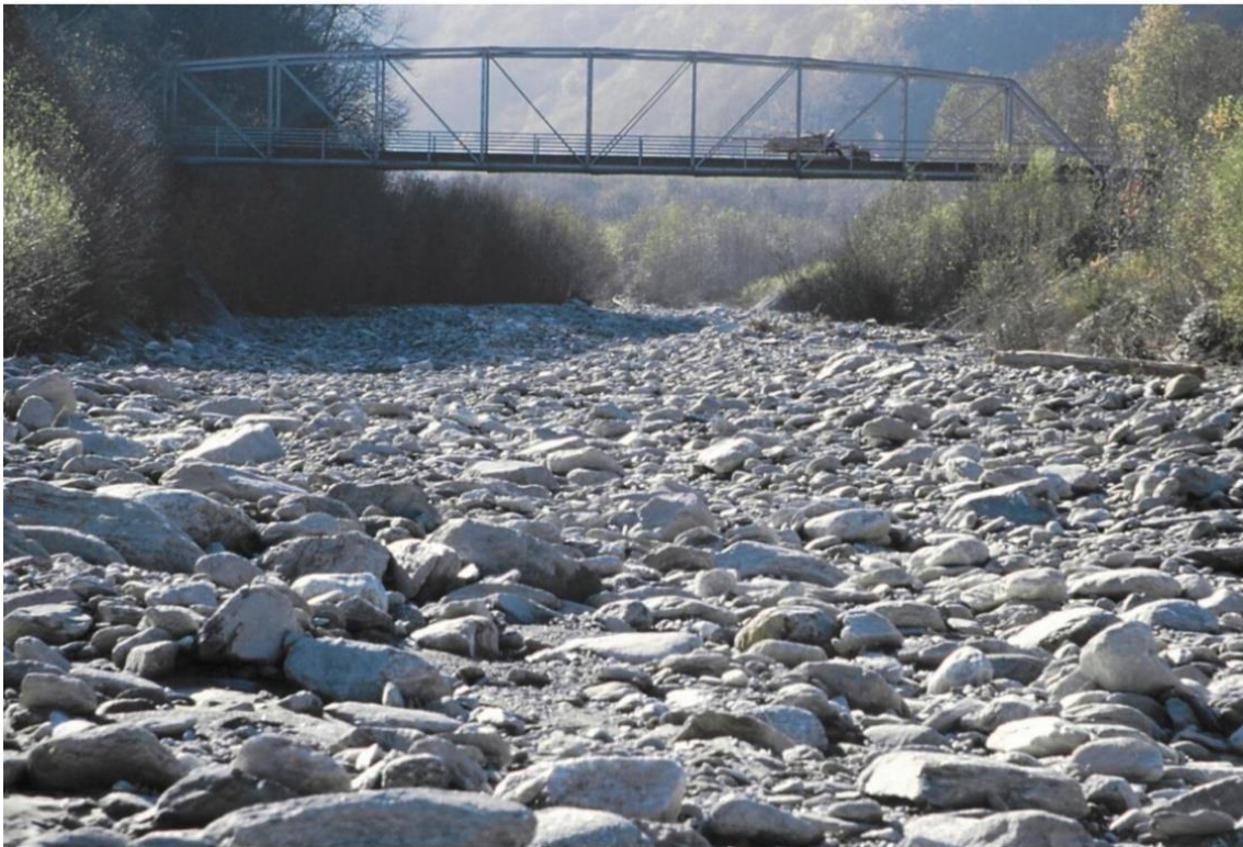
Abb. 14: Sumvitgerrhein/GR von den KVR/NOK/AXPO seit Jahrzehnten vollständig trockengelegt (Bild SGS, Okt 2008)
