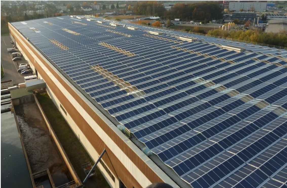
Abb. 43: Die 2.9 MWp-Photovoltaikanlage liefert jährlich 2.5 Mio. kWh und deckt ungefähr 7% des Strombedarfs aller 15'150 Einwohner/innen der Stadt Wohlen. (Schweizer Solarpreis 2013)
