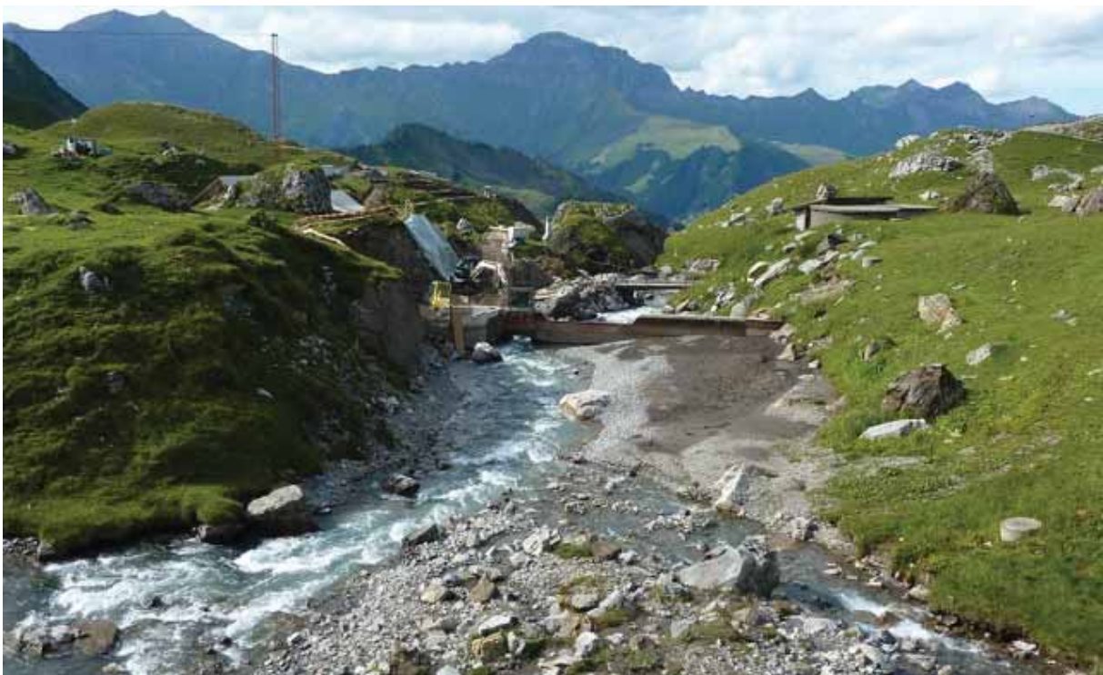
Abb. 16: Auch an der Engstligenalp/BE entsteht ein weiteres KWKW. (Bild: Dani Heusser)
