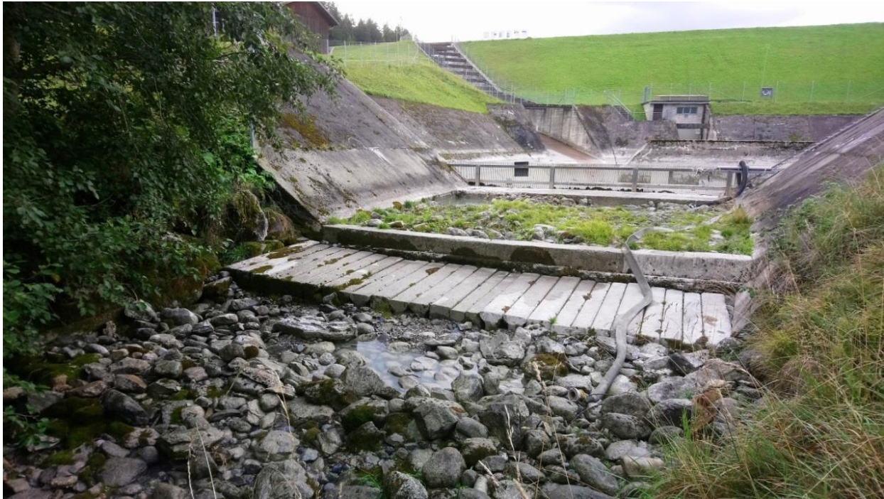
Abb.: 6 Der Flémbach in Brigels ohne verfassungskonforme Restwassermengen ab 1960 bis heute.
